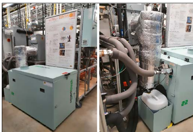
Abbildung 2: BHKW, Rauchgasstrang und Hochtemperaturstufe der AKM
