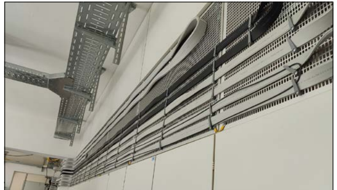
Abbildung 4: Flachbandkabel zur Versorgung der Antriebe im Labor
